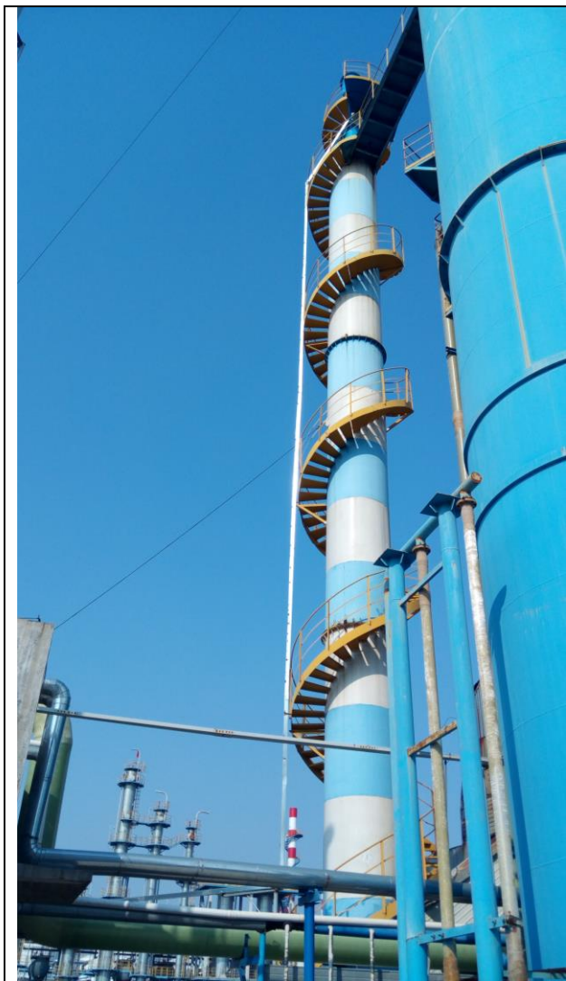
燃气导热油炉 35m 排气筒
